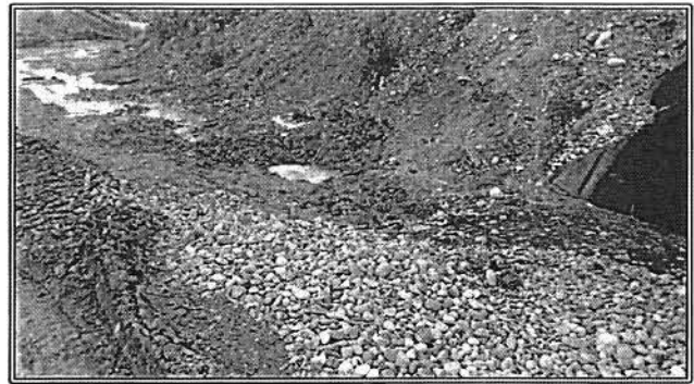
Filtración de agua de lluvia a la salida de la terraza
